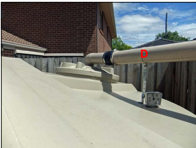
Fig 1.36 - “Wet leg” pipe (D) connecting into Manse Tank
